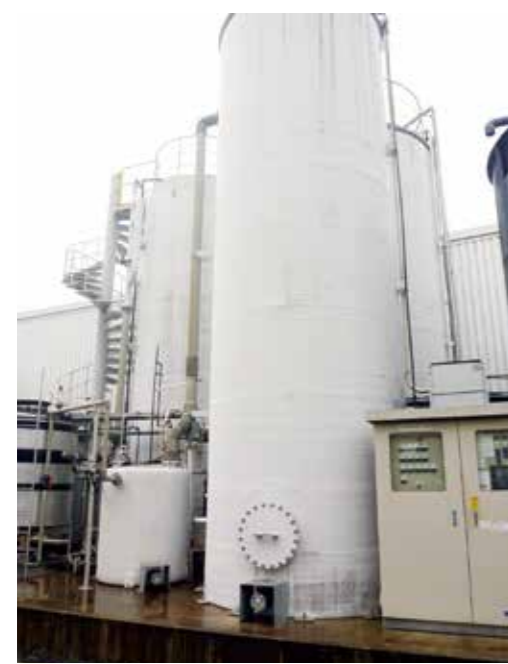
省エネに貢献する「バイオガス転換施設」
